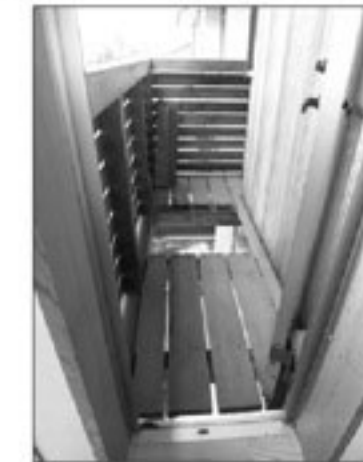
2階のベランダに設けられた避難ハッチ。
