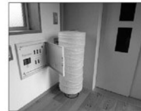
2階にもある配電盤。
