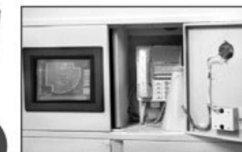
左から火災階表示板・非常電話（防災センターにつながる）・メガホン
